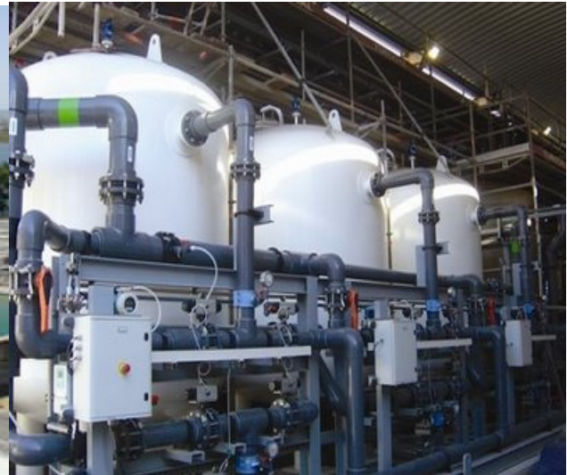
Usina dessalinização por osmose reversa
